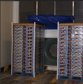
Túneles para preenfriado de frutas y hortalizas.
